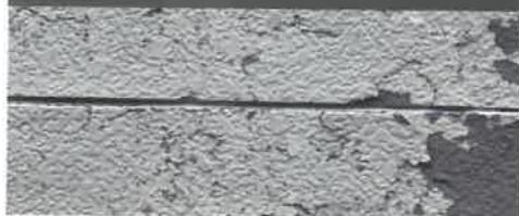
塗膜の剥がれ・色むら
